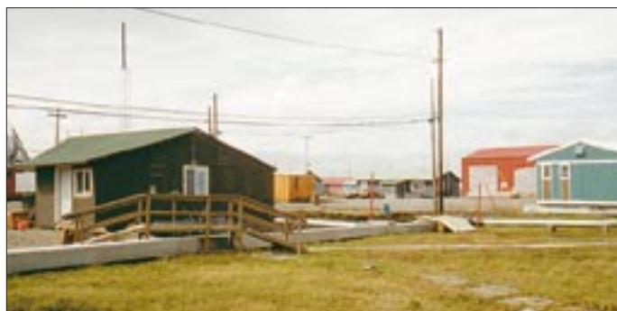
Anfänge der Kanalisation: In einem Teil des Dorfes überirdisch verlegte Abwasserleitungen (wegen des Permafrosts) mit Brücken für ATVs und Fußgänger
